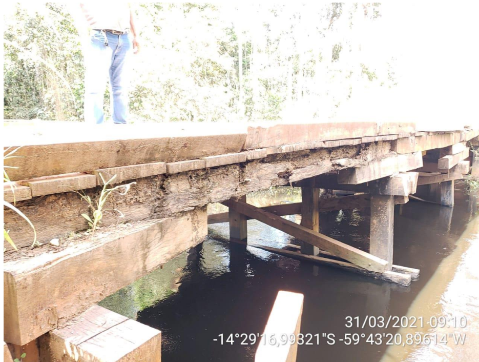
Ponte de madeira sobre a Vazão 1 do Rio Galera – 18,00m x 5,00m
